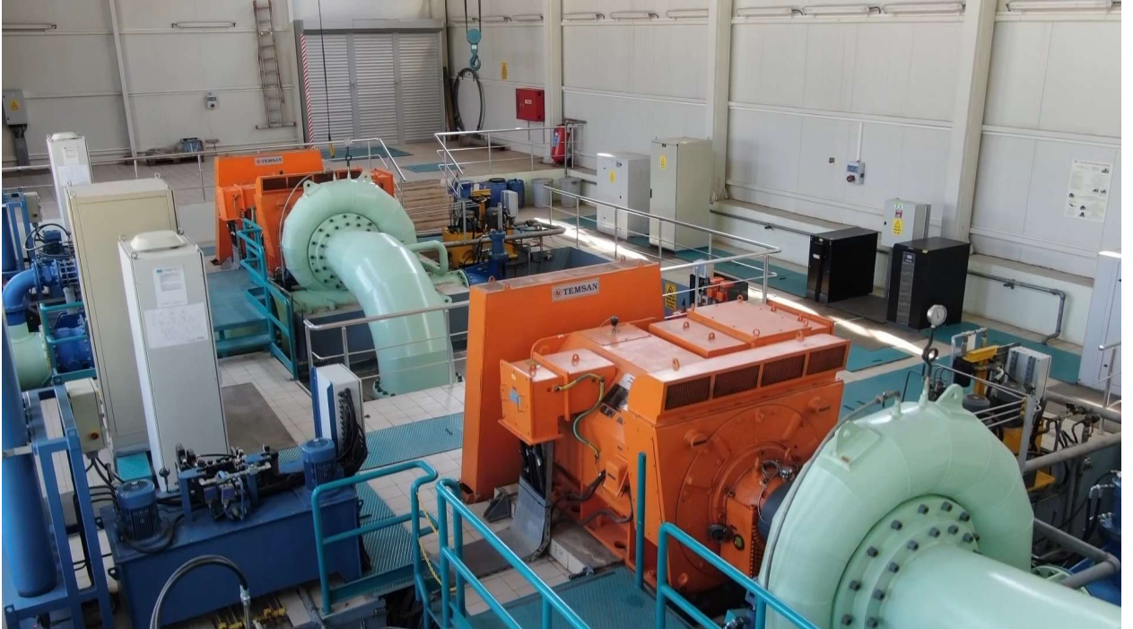
Yuvacık Hidroelektrik Santrali
