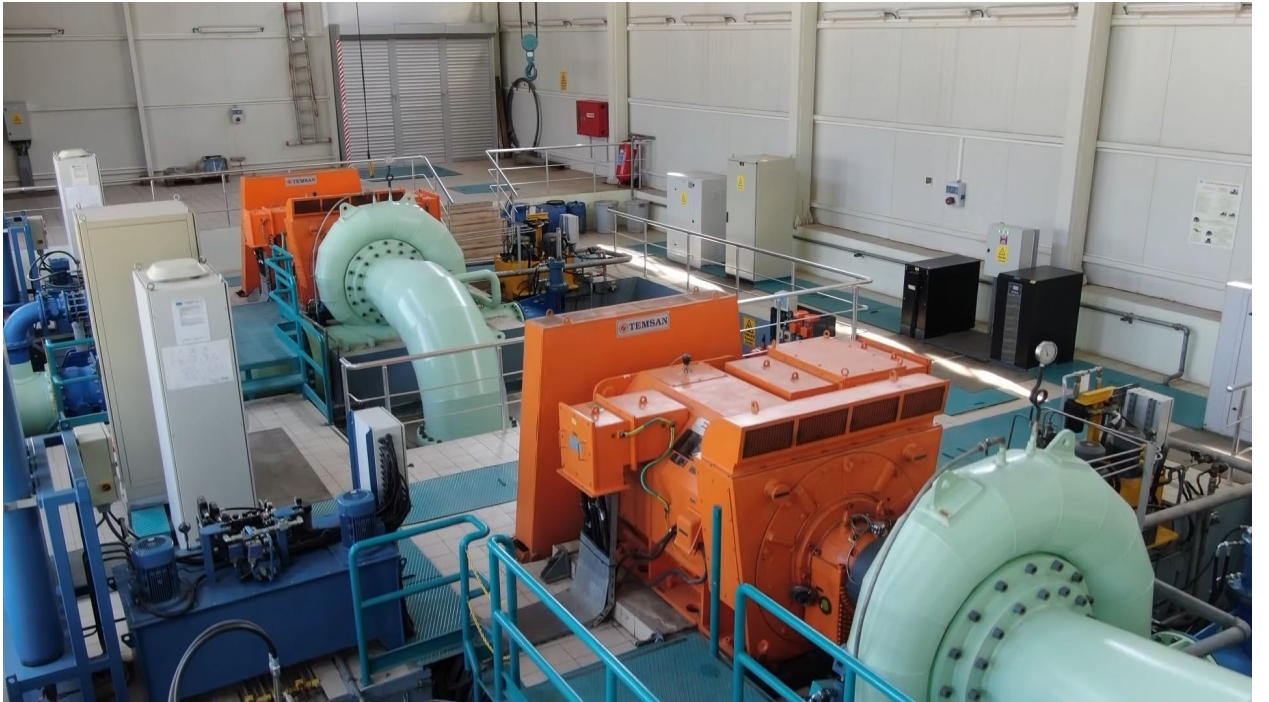
Yuvacık Hidroelektrik Santrali
